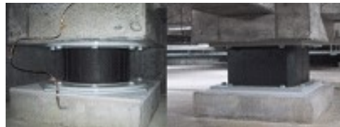
地下ピットに設置されたアイソレーター
